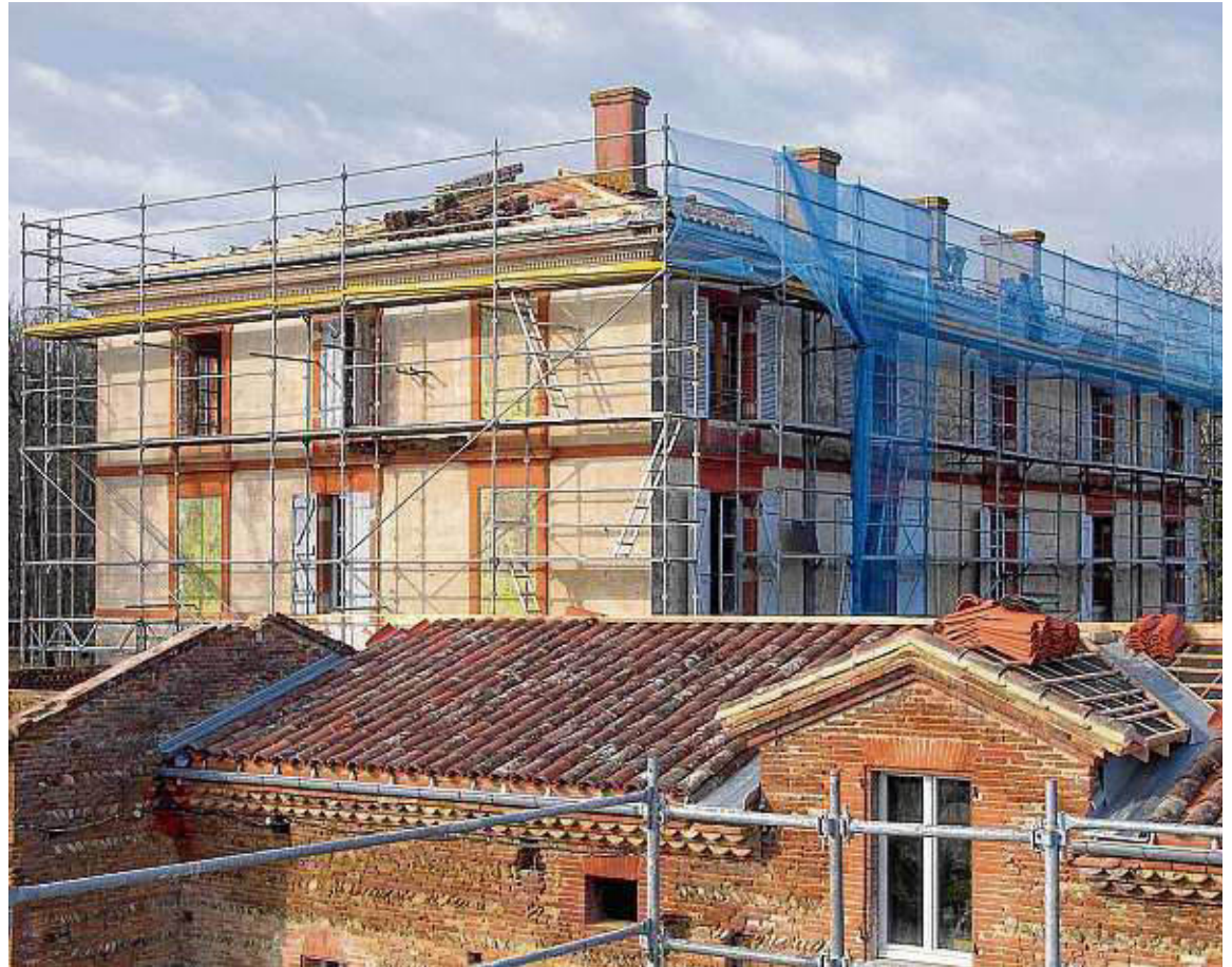
Die Arbeiten am alten Gutshof „Domaine de Redon“ bergen besondere Herausforderungen für Tröndle Haustechnik aus Waldshut. Das Aufgabenfeld war streng ökologisch ausgerichtet. BILDER: THT:
