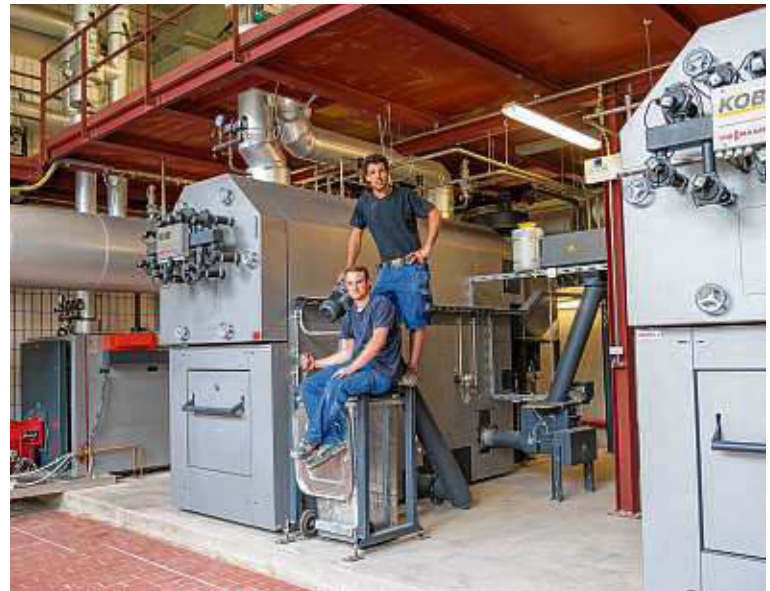
Die neue Heizzentrale der Reha-Klinik Wehrawald. Im Bild die beiden Mitarbeiter, Azubi Jonas Villingner und Bauleiter Matthias Baumgartner. BILDER: THT
