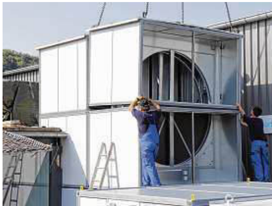
Technik zur optimalen Nutzung der Energie: der Rotationswärmetauscher für das Tiengener Möbelhaus.
