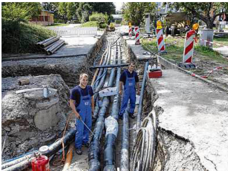
2,6 Kilometer Fernleitungen wurden verlegt, um private und öffentliche Gebäude anschließen zu können.
