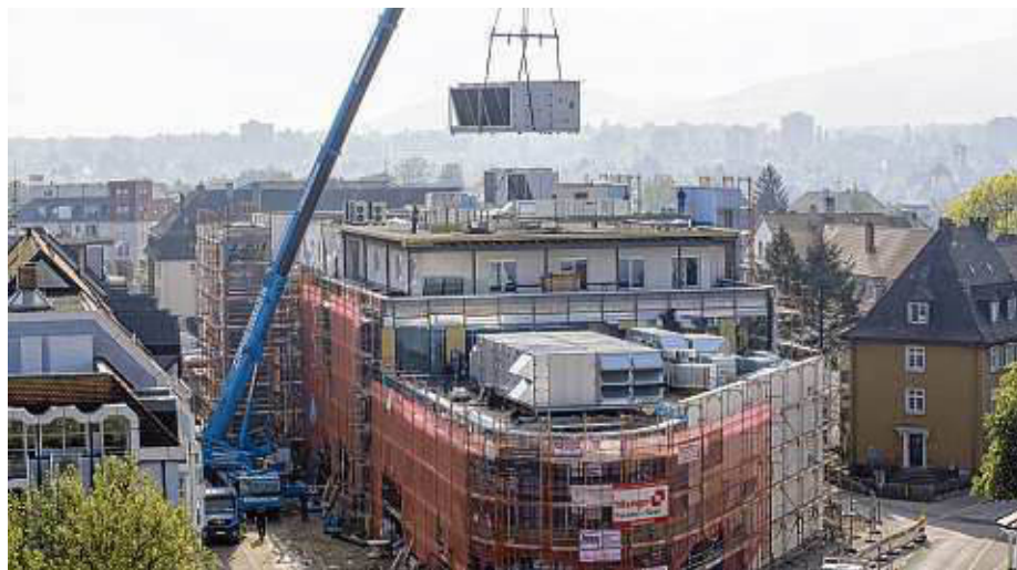
Ein riesiges Projekt und Herausforderung für Tröndle Haustechnik: Das neue Hochrhein-Center in Rheinfelden mit einer Nutzfläche von 7500 Quadratmetern. BILDER: THT
