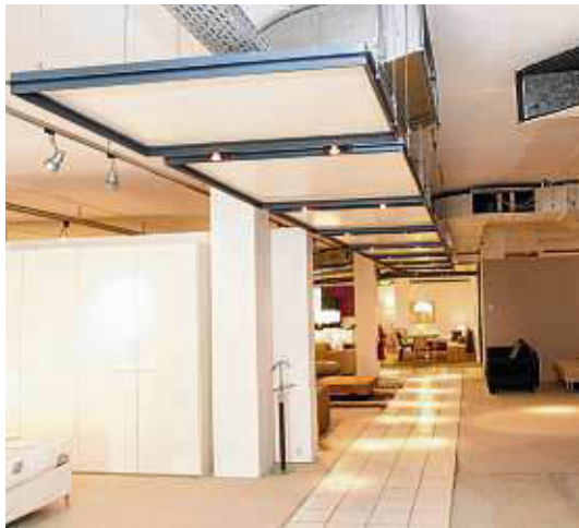
Lüftungskanäle an den Decken sorgen in allen Bereichen für ein angenehmes Raumklima.
