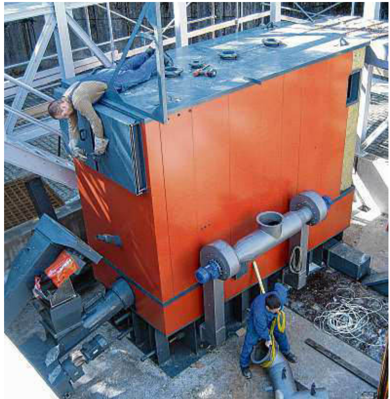
Der Kessel wird montiert, die Anschlüsse werden hergestellt. Im gesamten Gebäude wurden fünf Kilometer Rohrleitungen verlegt.
