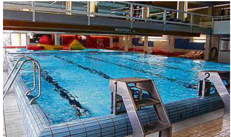
Auch im Waldshuter Hallenschwimmbad ist Tröndle Haustechnik für die Schwimmbadtechnik zuständig. BILDER: THT
