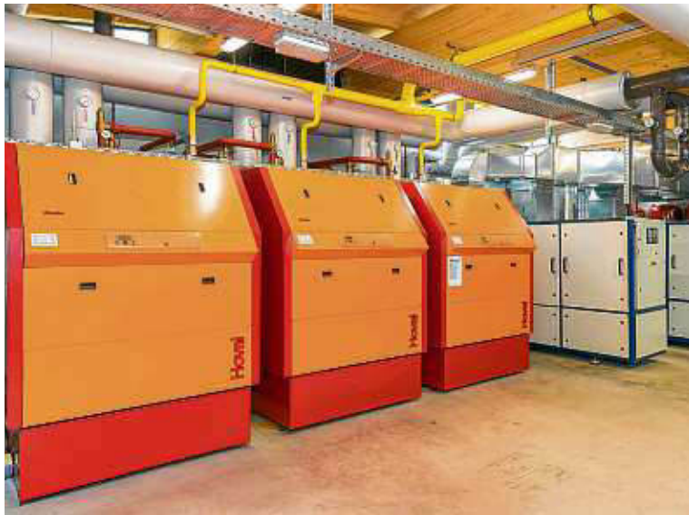
Die Heizzentrale im Tiengener Schulzentrum mit den drei BKH-Modulen. Angeschlossen ist neben den Schulen unter anderem die Stadthalle.
