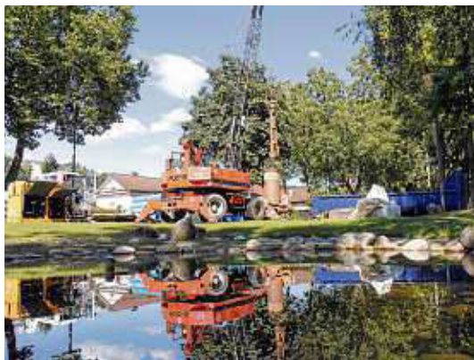
Der Teich im Park des Tiengener Möbelhauses wird zur Klimatisierung herangezogen.
