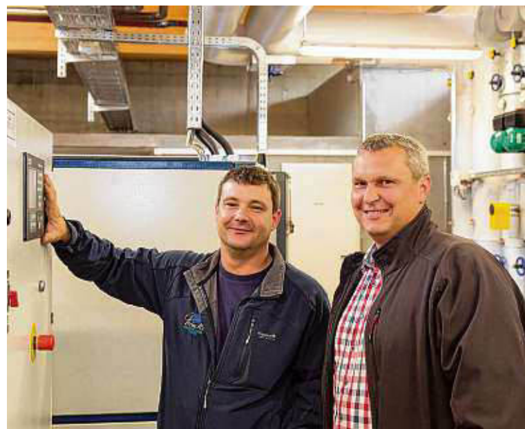
Daniel Peick, von Tröndle Haustechnik, und Andreas Schillinger von den Stadtwerken Waldshut-Tiengen in der neuen Heiztechnikzentrale im Schulzentrum in Tiengen. BILD: THT
